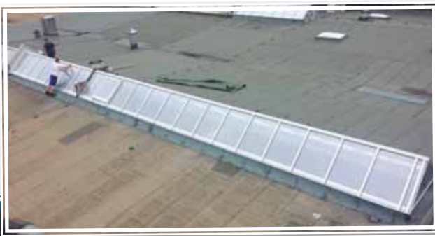
V podjetju Leso kras se ukvarjajo tudi z zamenjavo, montažo in servisiranjem svetlobnih trakov na večjih objektih.
