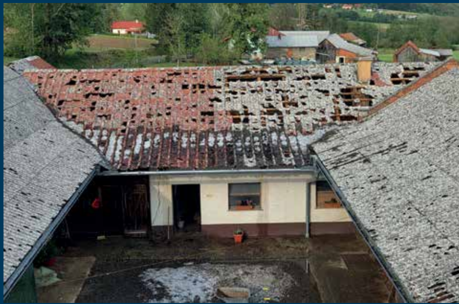
Silovito neurje je poškodovalo številne objekte na Goričkem.
